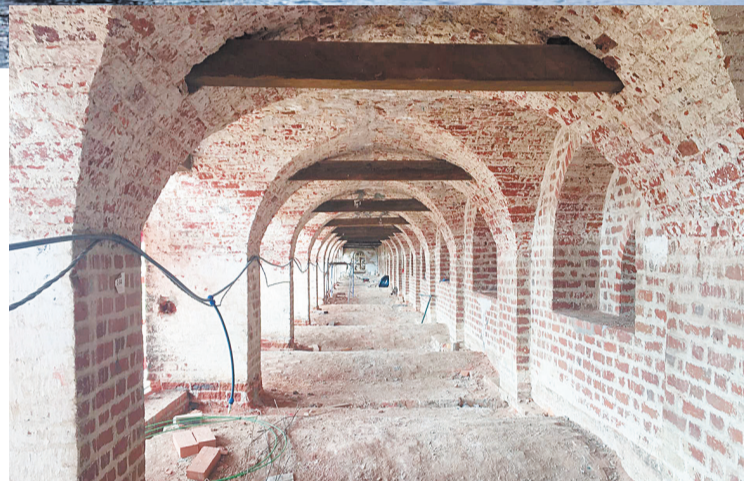
Уникальная возможность увидеть галереи-переходы между башнями до завершения реставрации. Потом по ним смогут гулять туристы.
